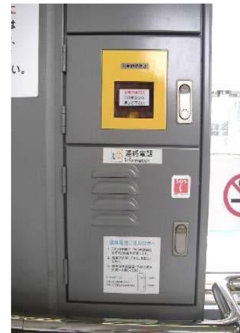
ホームドア横の非常停止ボタン
