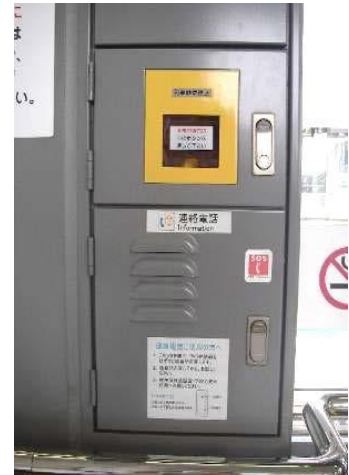
ホームドア横の非常停止ボタン
