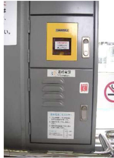
ホームドア横の非常停止ボタン
